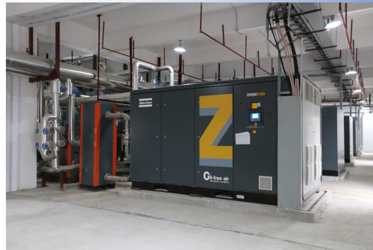
一级能效空压站现场图
