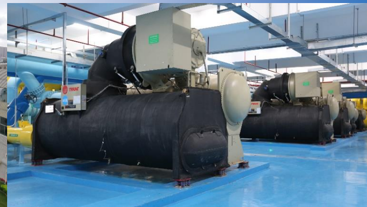
高效制冷机房现场图
